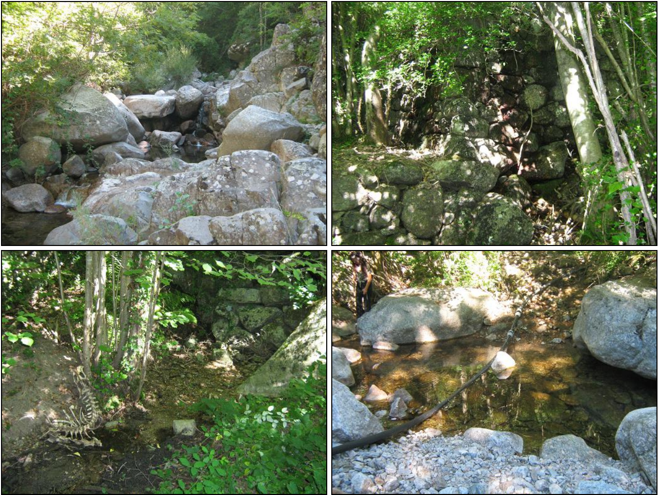
Figure 10 – Captage de Coudoulous (haut-gauche : torrent d'où l'eau est déviée ; haut-droit : enrochement construit ; bas-gauche : carcasse de cerf au pied de l'enrochement ; bas-droit : conduite en polyéthylène non enterrée)
