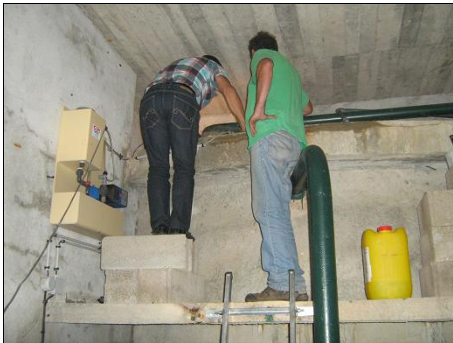
Figure 8 – Réservoir de Bions avec traitement à la javel
