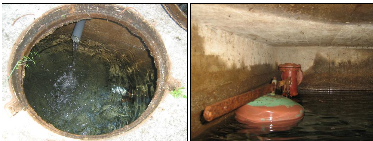
Figure 10 – Captage de l'Adret de Grimal (collecteur en bord de route : à gauche arrivée des eaux de l'Adret de Grimal ; à droite vanne à flotteur permettant l'arrivée des eaux de Coudoulous)
