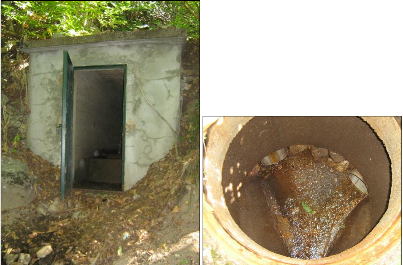
Figure 7 – Captage de Fontalard (extérieur et collecteur en bordure de route)
